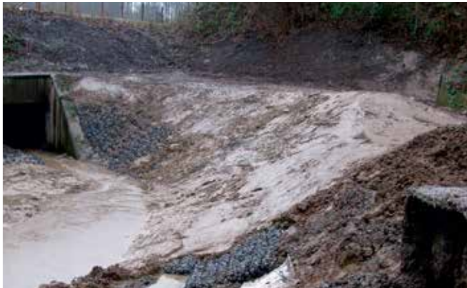
Abbildung 4.4.3.2 Die Böschung im Einlaufbereich ist besonders durch die Strömung belastet.
