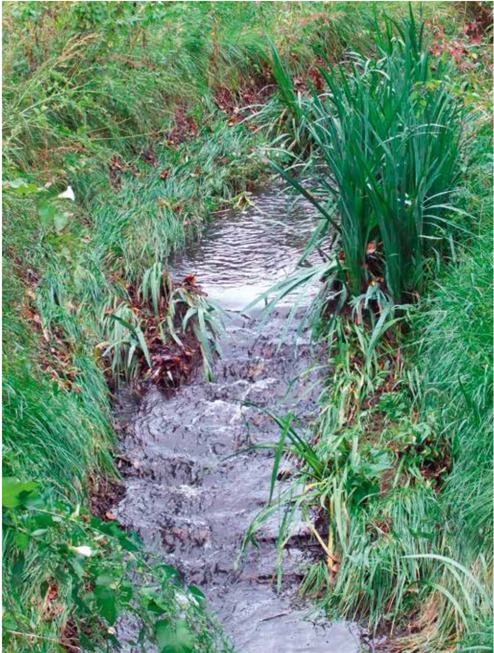
Abbildung 4.4.3.22 Bereits am Ende der ersten Vegetationsperiode ist auch der obere Böschungsbereich spontan begrünt. Die technische Sicherung ist praktisch nicht mehr zu erkennen.
