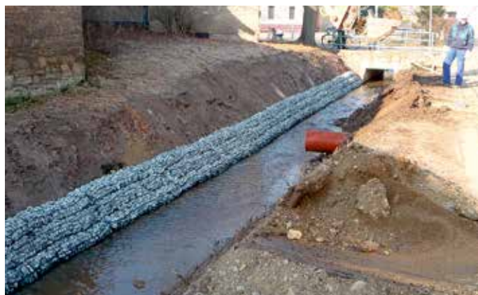
Abbildung 4.3.18 Aufgrund der dichten Bebauung ist eine lang fristige Sicherung der steilen Böschung notwendig (Steinwalzen dreilagig).
